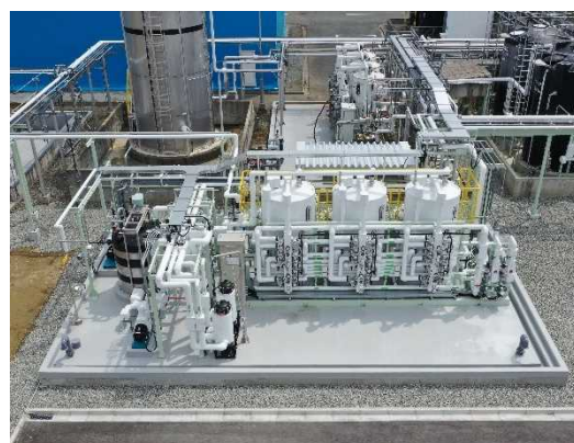
化学物質回収設備
