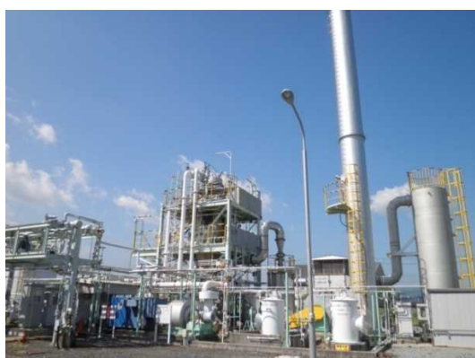
第一廃液燃焼設備
