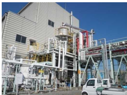
第一生産プラント排ガス処理設備
