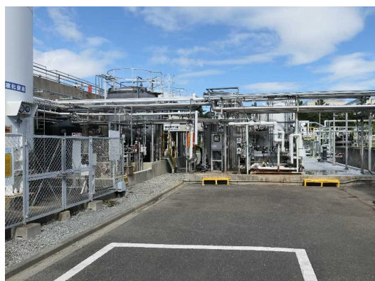
排水処理設備
