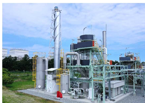
第二廃液燃焼設備
