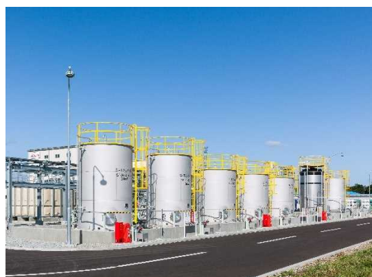
窒素シールされたタンク
