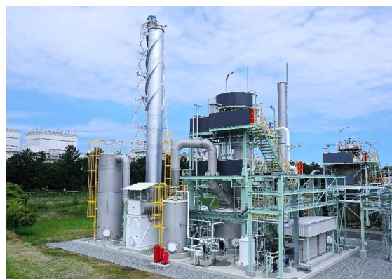
第二廃液燃焼設備
