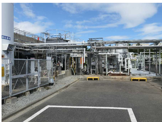
排水処理設備
