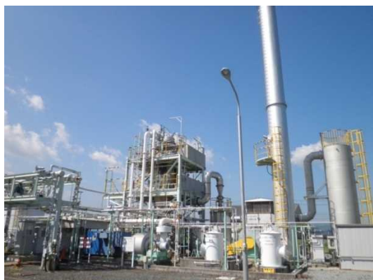
第一廃液燃焼設備
