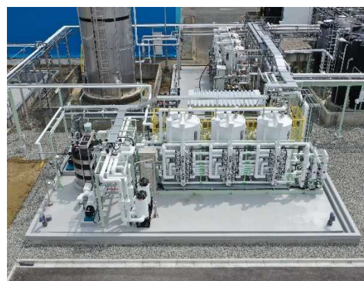
化学物質回収設備
