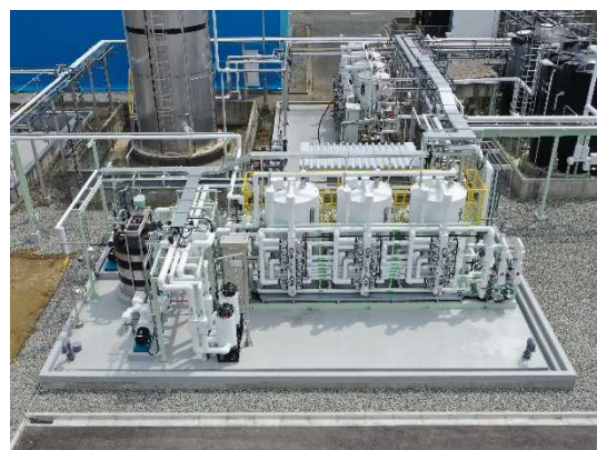
化学物質回収設備
