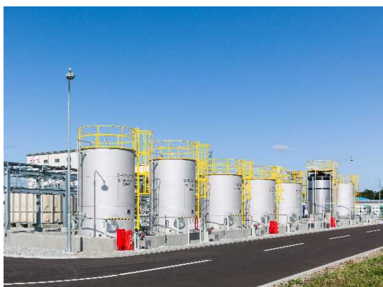
窒素シールされたタンク
