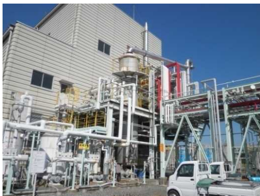
第一生産プラント排ガス処理設備
