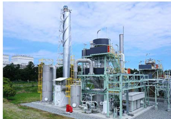
第二廃液燃焼設備
