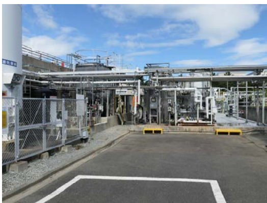
排水処理設備
