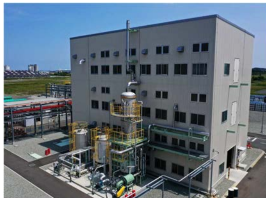
第二生産プラント SA-II 排ガス処理設備
