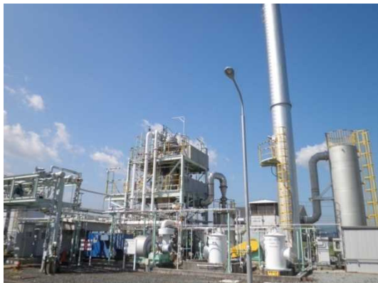
第一廃液燃焼設備
