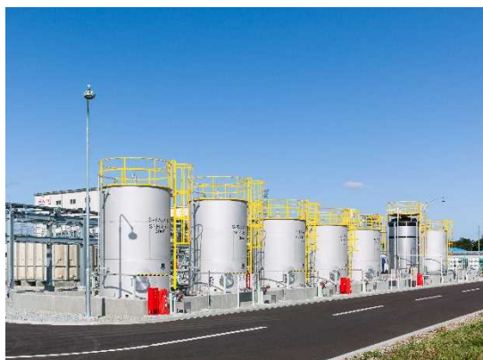
窒素シールされたタンク
