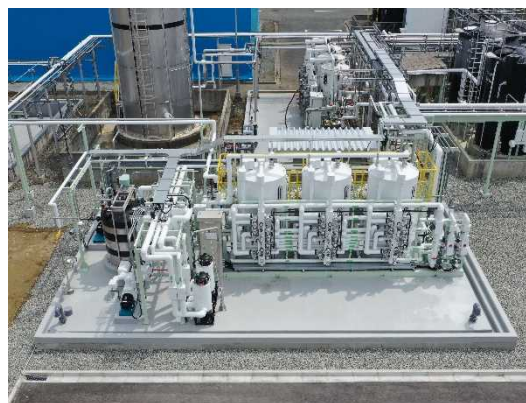
化学物質回収設備
