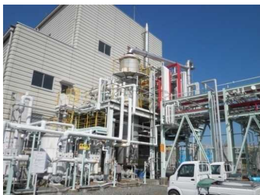
排ガス処理設備
