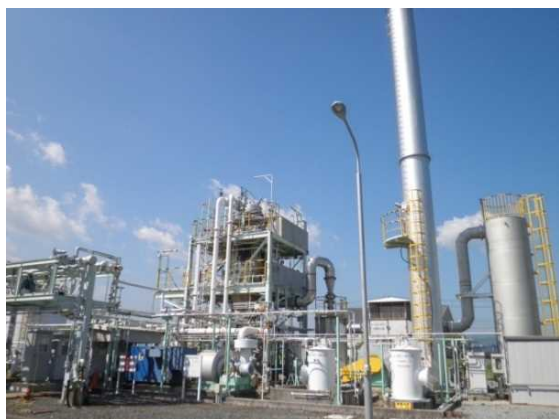
廃液燃焼設備
