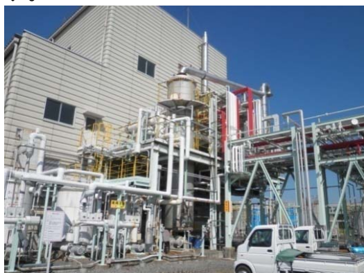
排ガス処理設備
