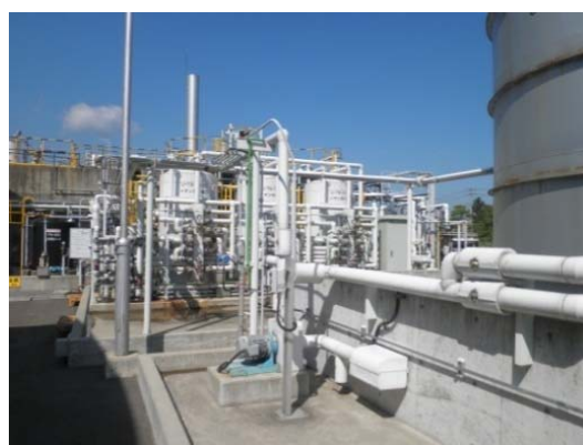
化学物質回収設備
