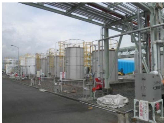
窒素シールされたタンク
