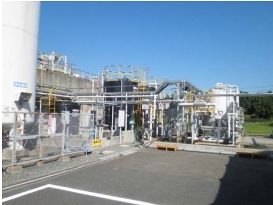
排水処理設備
