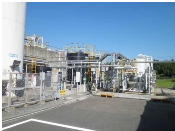
排水処理設備
