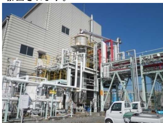
排ガス処理設備
