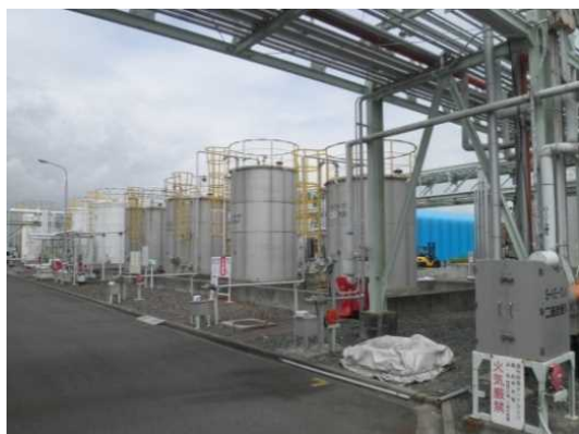
窒素シールされたタンク
