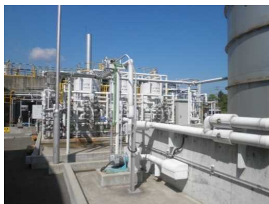
化学物質回収設備
