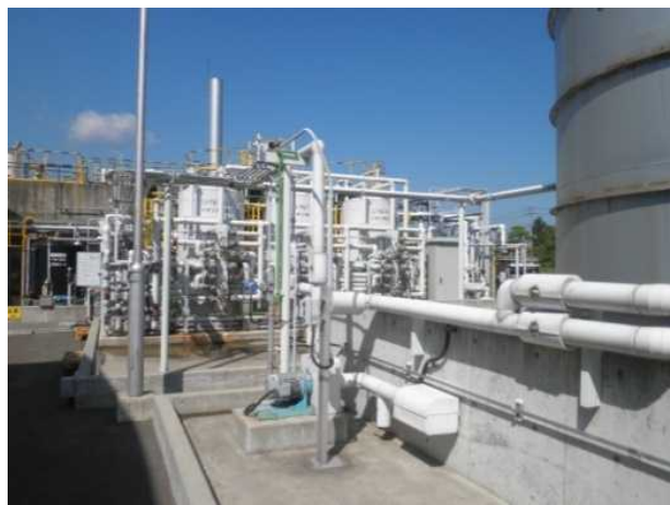
化学物質回収設備
