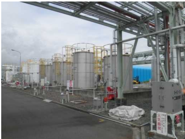
窒素シールされたタンク
