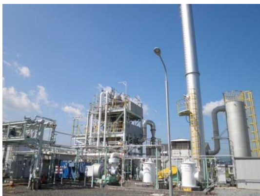
廃棄物焼却炉
