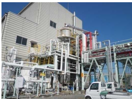
排ガス処理設備
