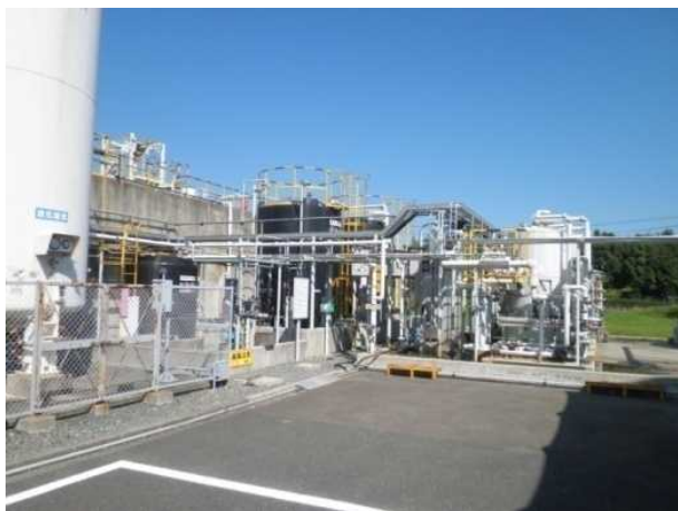
排水処理設備
