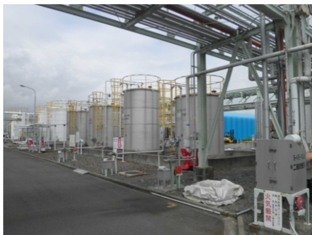
窒素シールされたタンク
