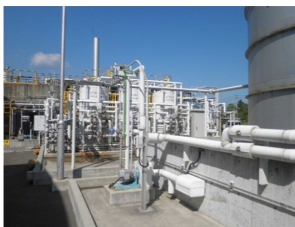
化学物質回収設備
