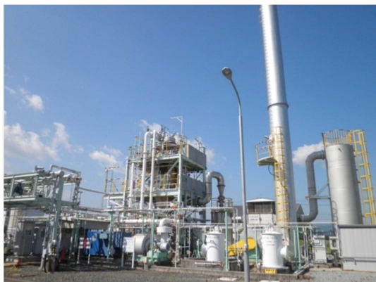
廃棄物焼却炉
