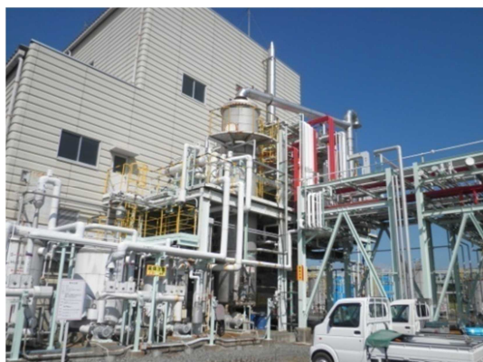
排ガス処理設備
