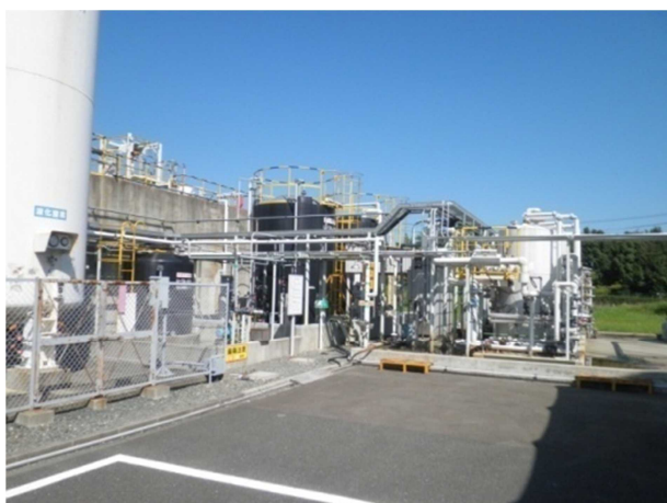
排水処理設備
