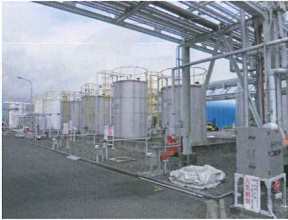
窒素シールされたタンク
