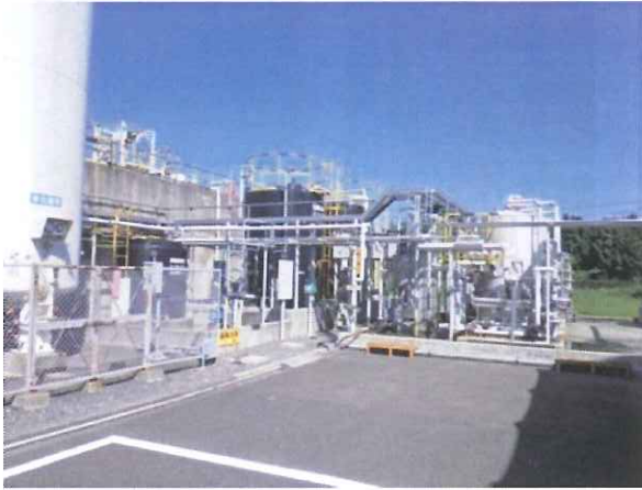
排水処理設備
