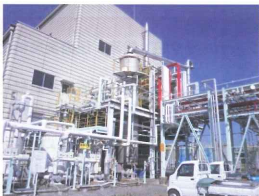
排ガス処理設備
