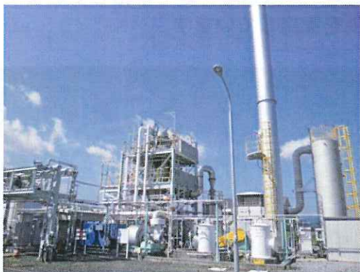
廃棄物焼却炉
