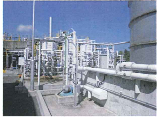
化学物質回収設備
