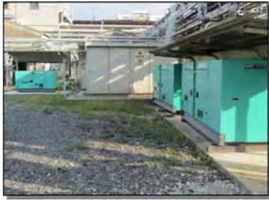
非常用ディーゼル発電機
