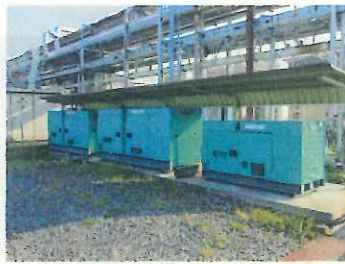
非常用ディーゼル発電機
