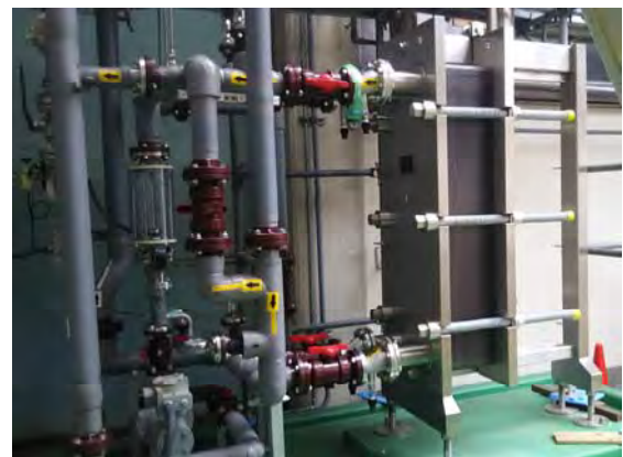
過硫酸塩類設備に導入 蒸気削減熱回収設備
