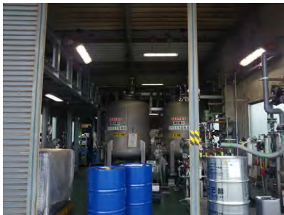
屋内照明にLEDを使用する TEC製品製造設備
