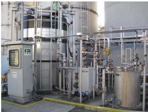
中和処理設備
