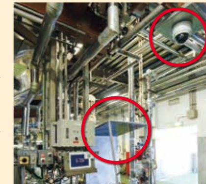
原料投入口の上方にカバーとモニタリングカメラを設置
